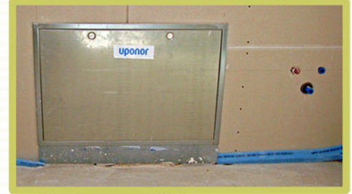
Colector de suelo radiante
