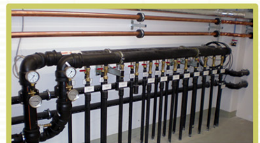
Colector interior de sondas geotérmicas
