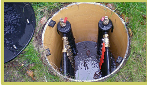
Colector exterior de sondas geotérmicas
